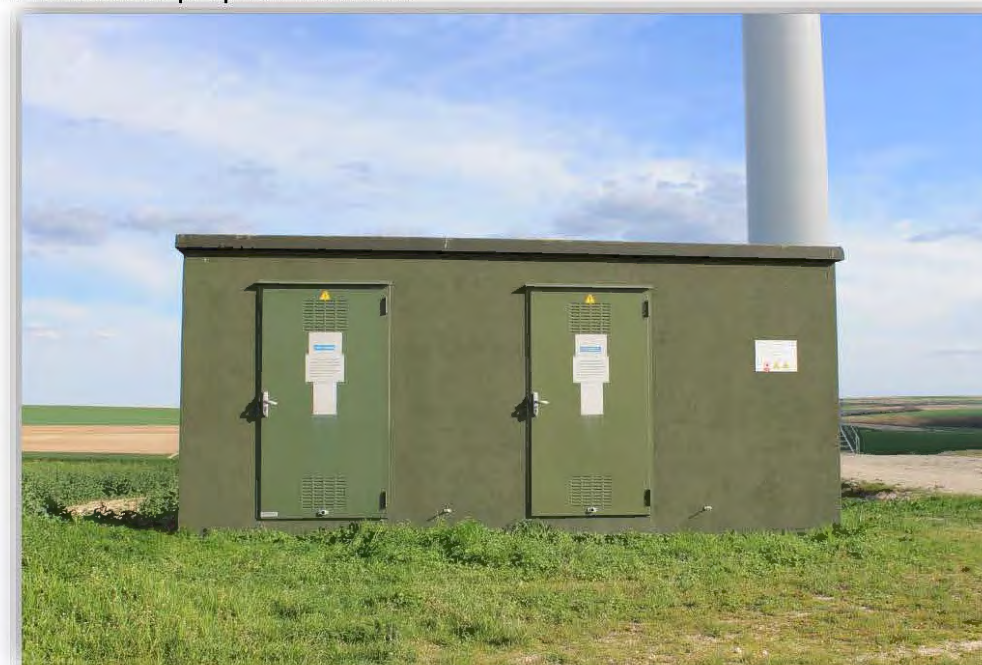
Figure 86 : Habillage du poste de livraison du parc
